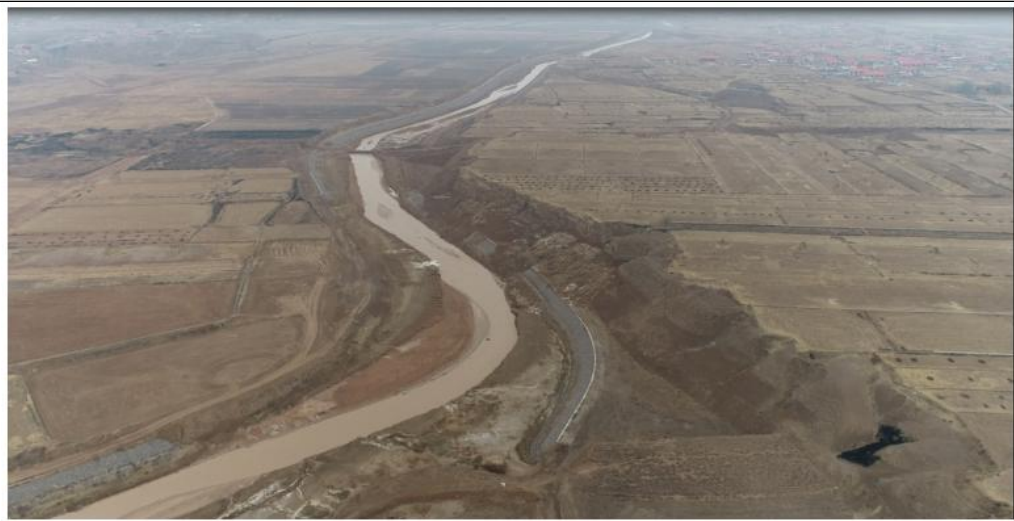
新堡护岸高边坡滑塌严重
