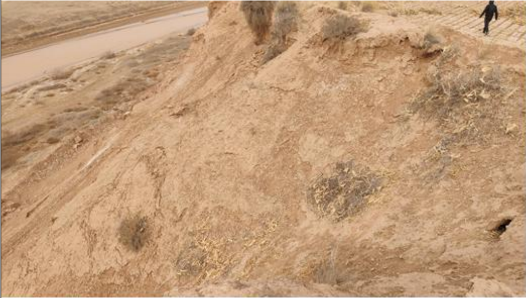
土质疏松，高边坡被雨水冲刷较为严重
