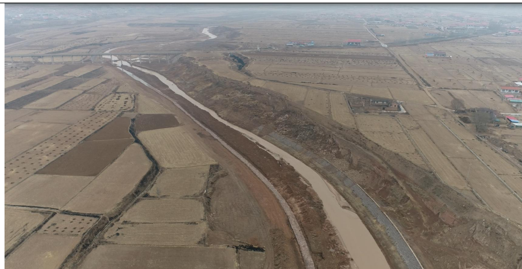
西沟入河口护岸高边坡滑塌严重
